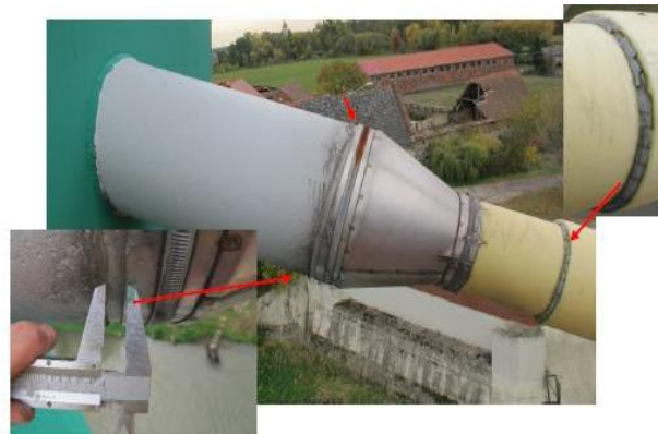
Fot. 10. Widoczne przemieszczenie, zsuniecie się kołnierza osłaniającego (o 10 mm), zniszczone uszczelnienia kołnierza
