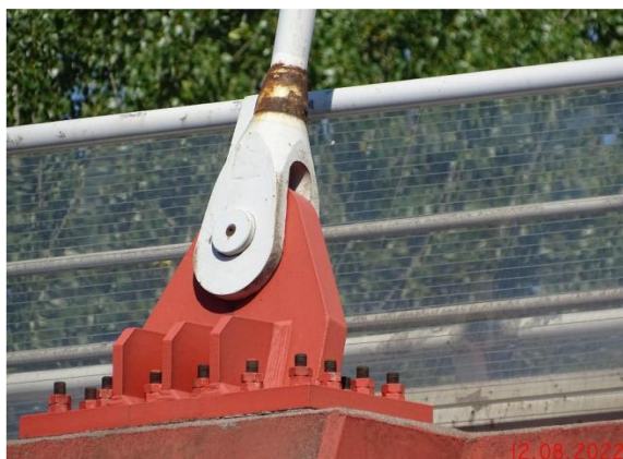
Fot.10. Korozja ciężna prętowego w strefie zakotwienia
