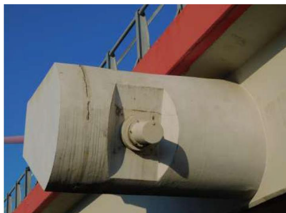
Fot. 6. Zarysowania na całej powierzchni górnej bloku kotwiącego. Rozwartość rys do 0,3 mm. Odspojenie powłoki z zapraw
