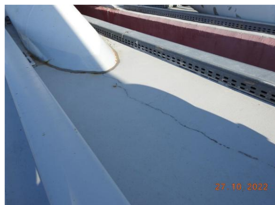
Fot. 4. Zarysowania dźwigara w rejonie zakotwień
