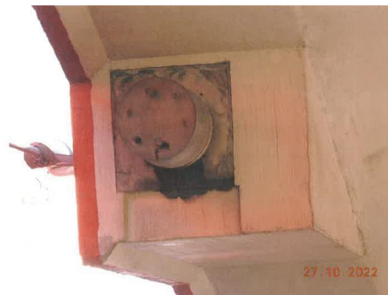
Fot. 8 Wycieki smarów zabezpieczających z zakotwienia cięgien, korozja osłony zakotwienia, korozja płyty oporowej
