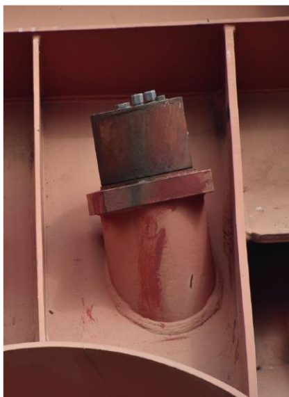
Fot. 9 Korozja i zniszczone zabezpieczenie antykorozyjne zakotwienia
