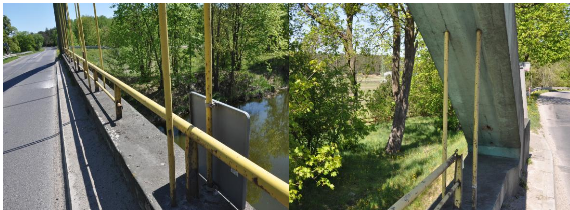
Fot. 7. Punktowe ogniska korozji wieszaków
