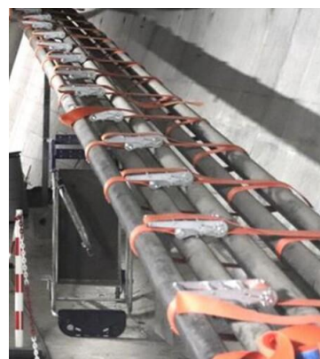
Fot. 7. Przykład zabezpieczenia kabli pasami transportowymi [5]
