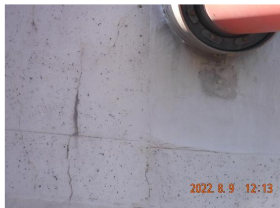
Fot. 2. Spękania betonu na słupach podtrzymujących ciągną
