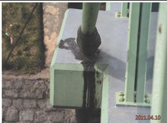
Fot. 7 Wyciek medium konserwującego w strefie zakotwienia
