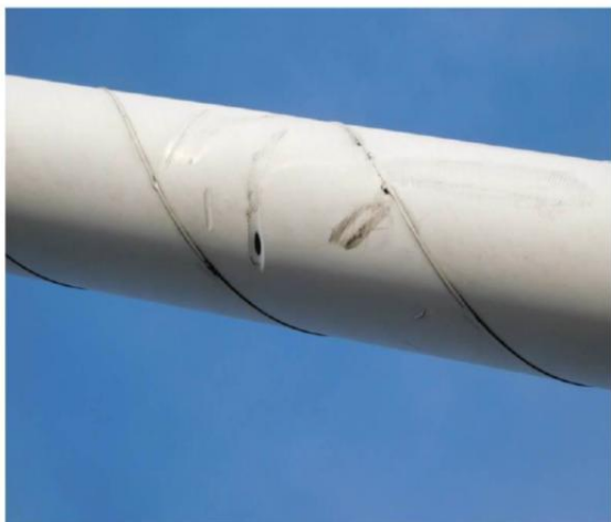
Fot. 7 Miejscowe przetarcie osłony wanty, uszkodzenie mechaniczne z etapu budowy, transportu lub składowania
