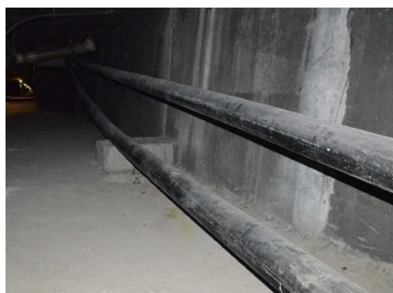
Fot. 6. Widoczny zwis nienaprężonego kabla (dolnego) w miejscu oddalonym od miejsca zerwania [4]
