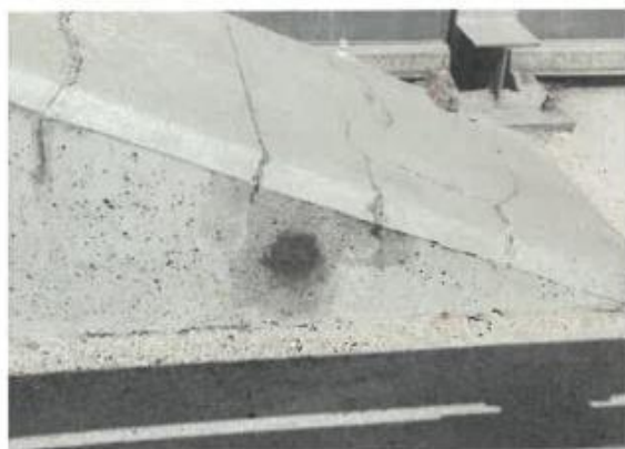
Fot. 3. Lokalne, poniżej wartości normowych, zarysowania betonu bloków kotwiących
