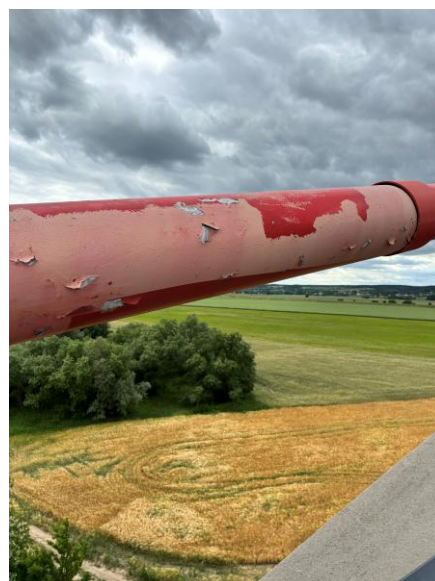
Fot. 14. Ubytki, delaminacja powłok antykorozyjnych
