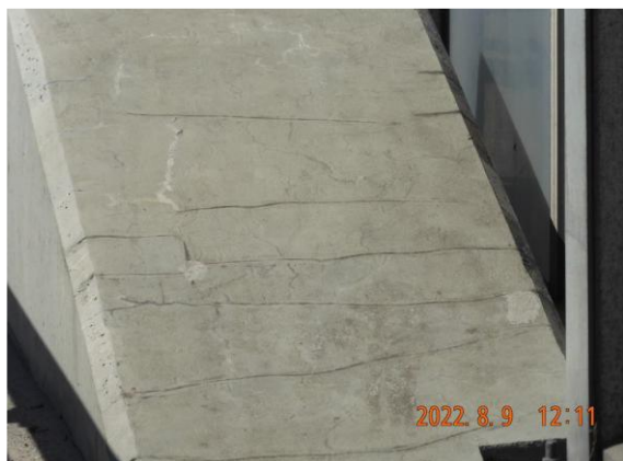
Fot. 1. Spękania betonu zakotwień cięgien
