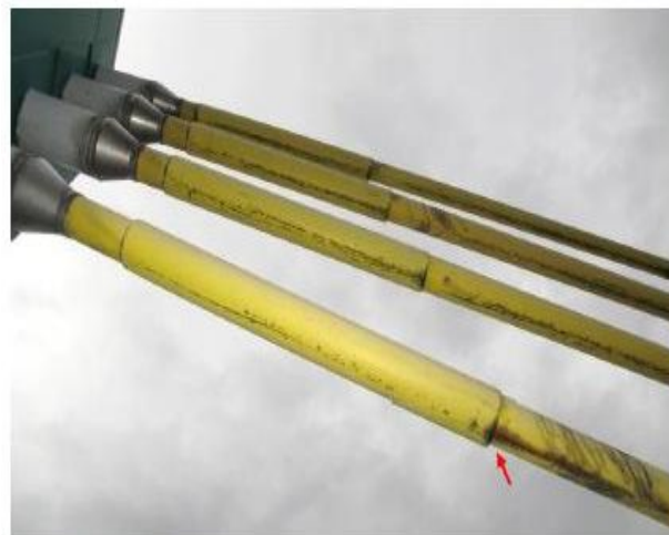
Fot. 8 Zakotwienie want w pylonie, ogniska korozji w kołnierzach osłaniających zakotwienie oraz drobne ilości smaru i zanieczyszczeń na spodzie rur osłonowych
