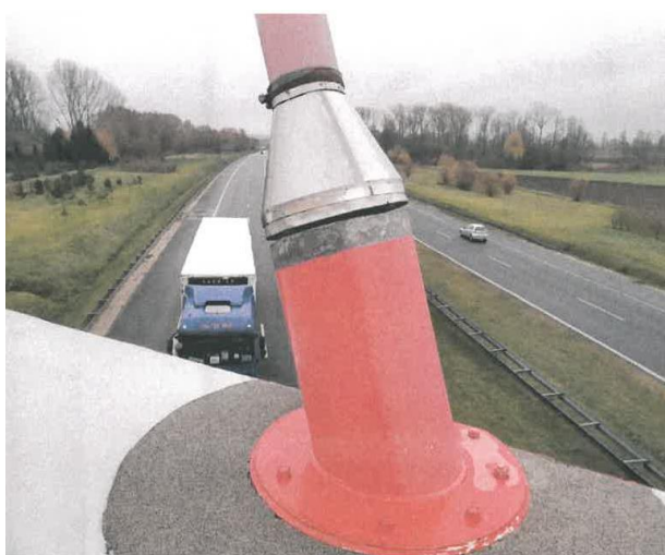
Fot. 11. Przesunięcie osłony ciągn
