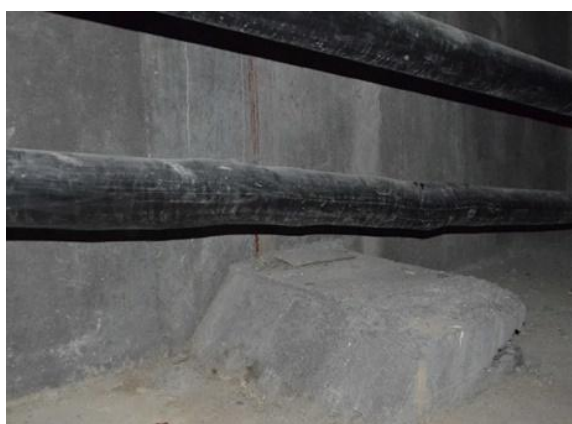
Fot. 5. Widoczne deformacje osłony spowodowane zerwaniem kabla [4]
