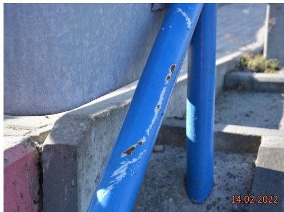
Fot. 9 Punktowa korozja i zniszczenie zabezpieczeń antykorozyjnych wieszaków
