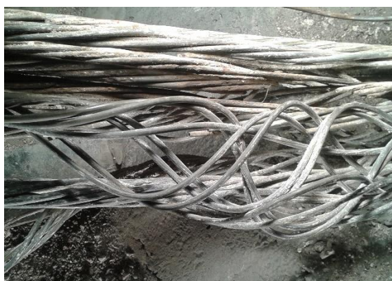
Fot. 3. Obraz w miejscu zerwania kabla po usunięciu osłony i iniektu (nie wszystkie liny uległy zerwaniu w tym samym przekroju) [3]
