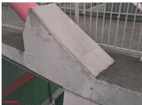
Fot. 5. Rysy na powierzchni dźwigara o rozwartości do 0,1 mm
