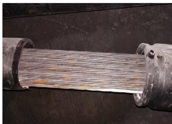
Fot. 4. Przerwana ciągłość osłony w miejscu jej łączenia na skutek zerwania kabla [4]
