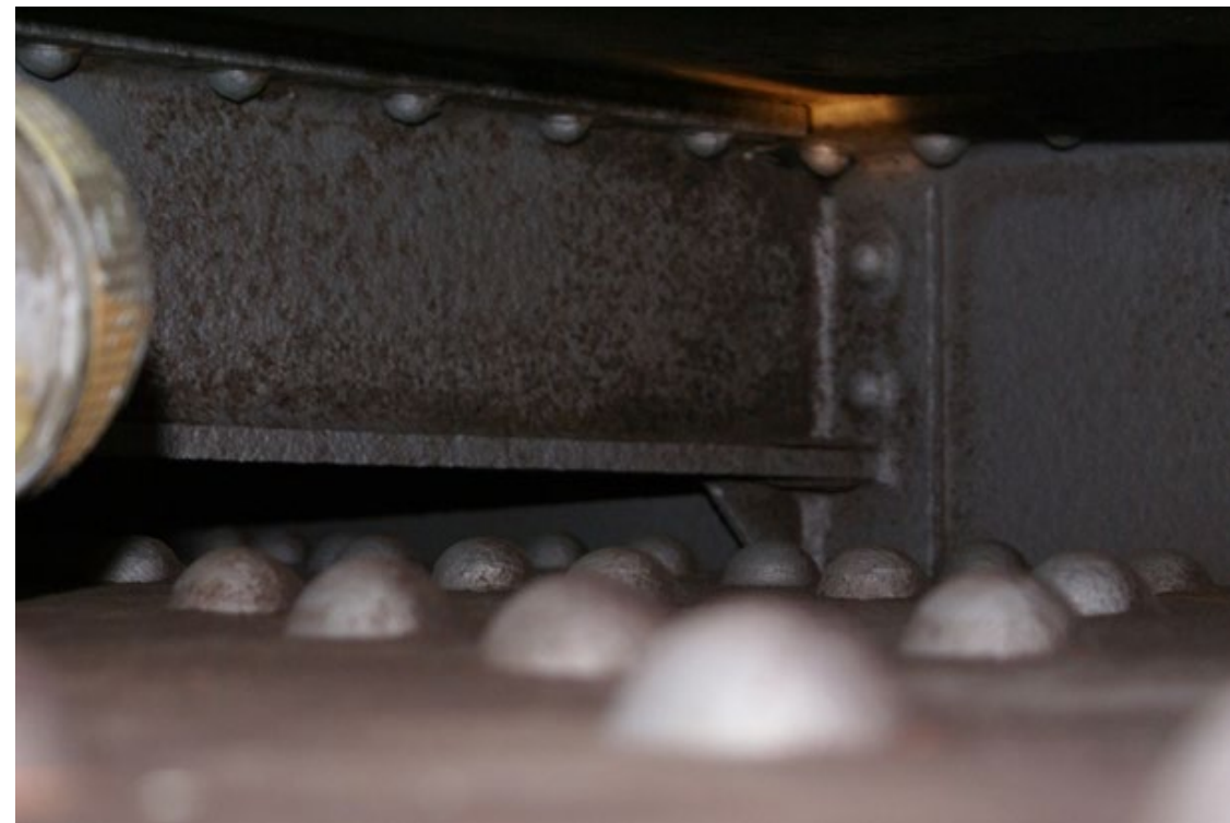
ROZMIAR PRZESTRZENI UNIEMOŻLIWIA WYKONANIE PRAC ANTYKOROZYJNYCH
